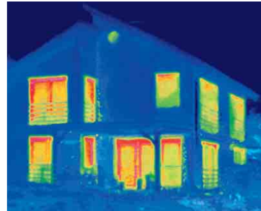
Infrarotaufnahmen – Thermografien – zeigen deutlich, wo ein Haus unkontrolliert Energie verliert. Rot bedeutet Wärme- und damit Energieverlust.
